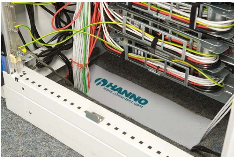
Hanno® Clima-Tect® in Rechenzentrum
